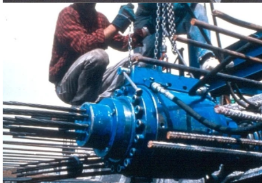
Figure 9 : Vérin de mise en tension.
