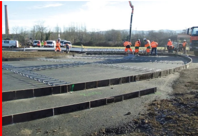
Chaque branche du giratoire a été dotée d'une dalle de transition (au premier plan) entre la chaussée en enrobé
