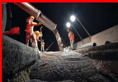
La minéralisation du TPC de l'A47 a été réalisée avec du Rempleco, produit fluide de remblayage et d'élargissement de Colas.
