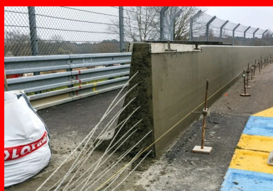
Les glissières FIA-FIM comportent 17 filants métalliques (torons).
