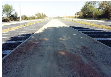
Pour accueillir les futurs clients du village des marques de Miramas, AER a réalisé les bordures des parkings en béton extrudé (17 cm de haut, 10 cm de large).
