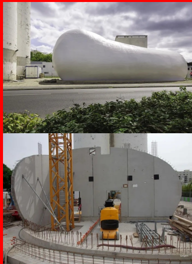
Vue de profil, partie émergée de la station de pompage réalisée en béton projeté.
