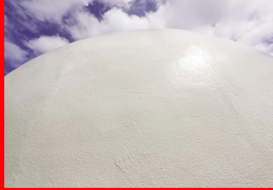
Le grain de la structure : une résine imperméabilisante de 2 mm, projetée au pistolet.
