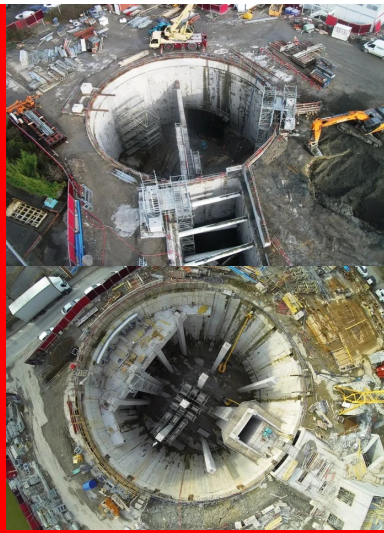
La station de pompage avec la bache de réception en partie centrale.
