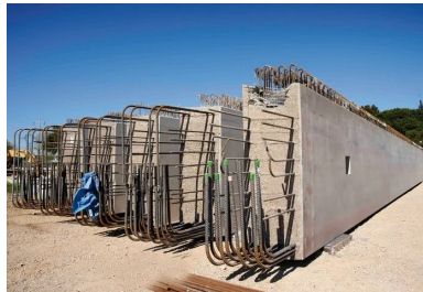
Les poutres préfabriquées en béton armé des estacades du viaduc du Lez et de la Lironde.
