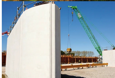
Une pile du futur viaduc (576 m) du Lez et de la Lironde.
