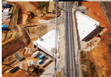
La dalle en deux éléments de la tranchée couverte de Manduel (3 000 et 4 000 t) a été mise en place en 60 heures et 81 heures !
