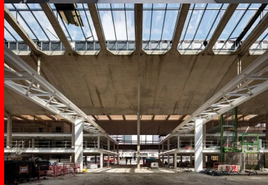
La halle est constituée de minces voûtes en béton (5 cm au faîtage) supportées par de fins piliers pyramidaux.
