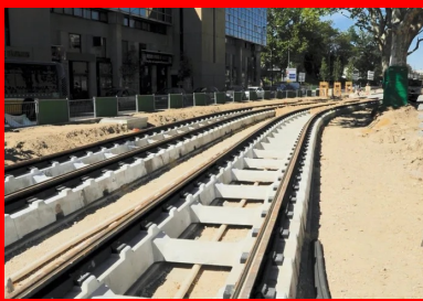
Plate-forme en « ladder track », destinée à accueillir une couverture végétale sur la séquence 1, le long des remparts historiques.
