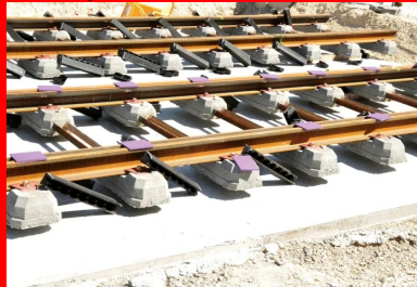
La partie sous patin de l'habillage des rails en mousse polyuréthane. Ces pièces (semelles élastiques) garnissent les rails avant le coulage du béton de calage. D'autres pièces viendront garnir les flancs du rail avant le coulage du béton de revêtement.
