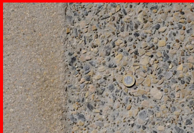
En gros plan, le béton désactivé intégrant deux types de granules : beige (6/16 S0V à 60 %) et noir (6/16 La Môle à 40 %).
