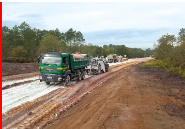
Sur l'emprise de la future voie, les étapes classiques du traitement se succèdent. Le sol ayant été préalablement décapé et mis en forme pour respecter le profil en long, la teneur en eau est vérifiée et éventuellement rectifiée. Puis les deux épandeurs de liants entrent en action, rapidement suivis par les deux malaxeurs agissant en parallèle.
