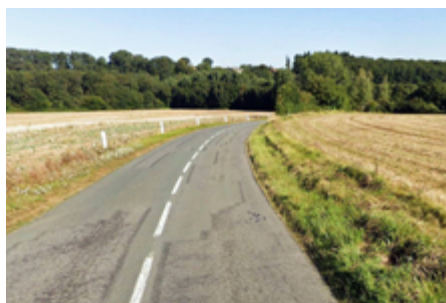
▲ État de la chaussée de la RD7 sur la commune de Brux, avant les travaux de réhabilitation. (©Ludovic Padeloup/Conseil départemental de la Vienne)
