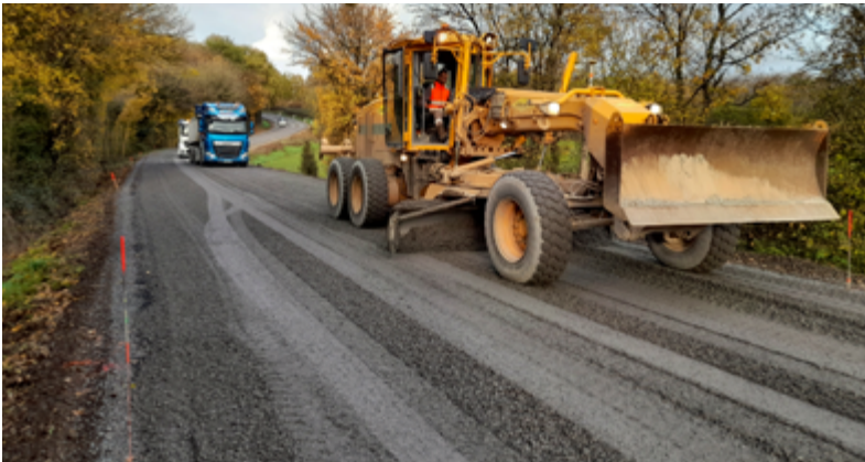
▲ Mise en œuvre de la couche anti-remontée de fissures en grave non traitée sur une épaisseur de 8 cm. (©Ludovic Padeloup/Conseil départemental de la Vienne)
