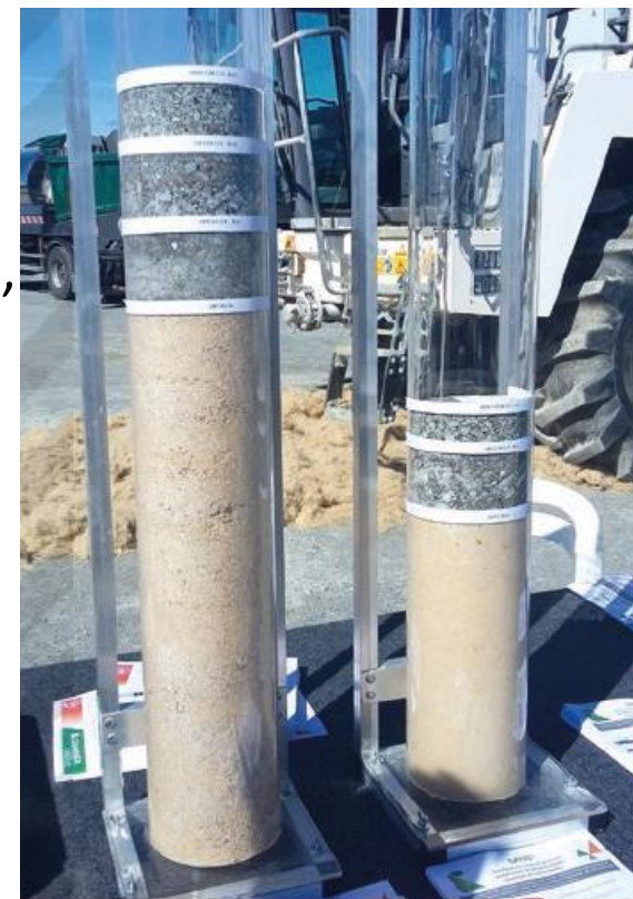
Épaisseurs couche de forme : - GNT = 0,50 m (à gauche) - Sol traité = 0,35 m (à droite)
