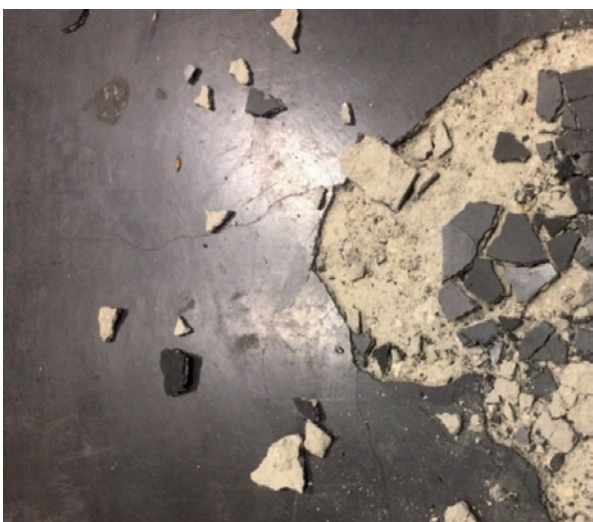
44. Délaminage avec rupture cohésive (crédit UNESI)
