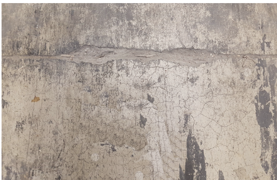
41. Exemple de joint épaufré - D.R.
