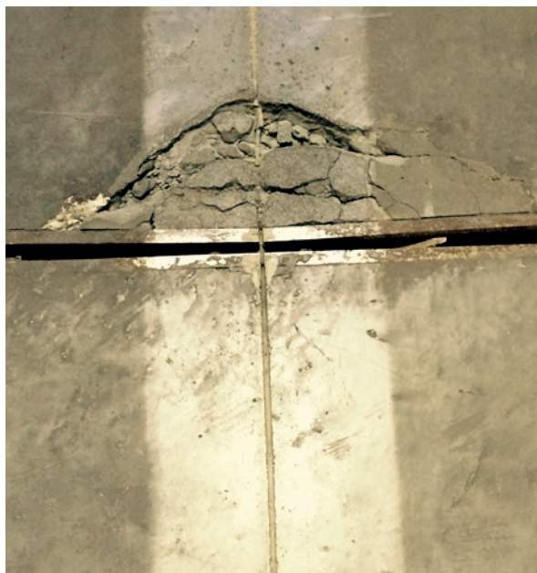
43. Arrêt de coulage à réparer (crédit SIFLOOR)
