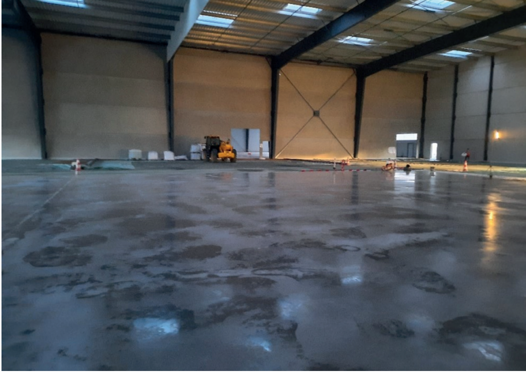
30. Exemple de dallage fini avec produit de cure non encore éliminé - (crédit PLACEO)
